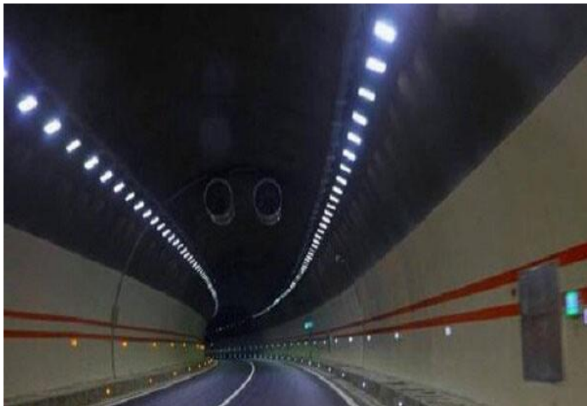
隧道内照明采用LED灯
