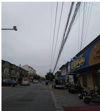
架空的电力线
