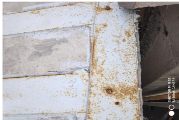
图 1-6 106#钢板锈蚀、脱空 15cm
