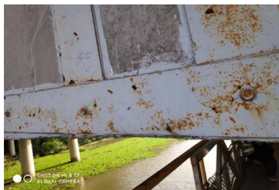
图 1-24 钢板下压条锈蚀、涂层剥落
