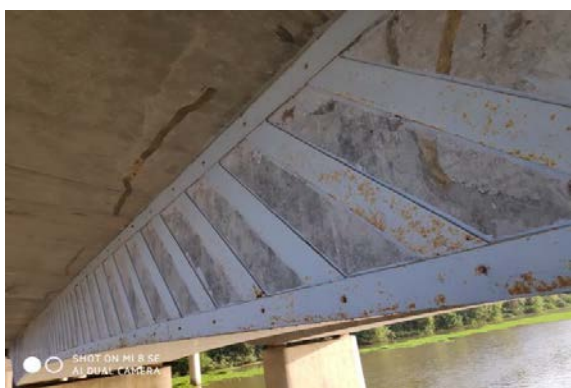
图 1-21 钢板下压条锈蚀、涂层剥落
