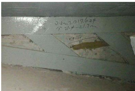
图 1-1 外侧腹板箱内面纵向裂缝
