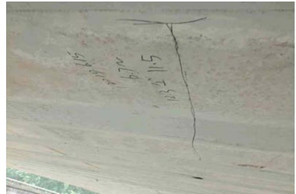
图 1-14 底板箱外面纵向裂缝
