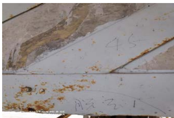
图 1-22 42#钢板下压条脱空 20cm
