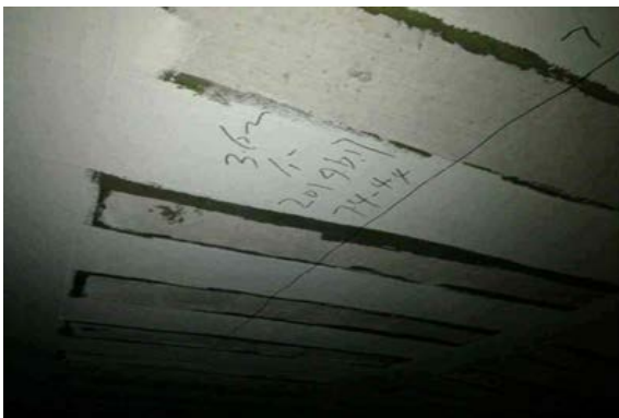
图 1-15 顶板箱内面纵向裂缝
