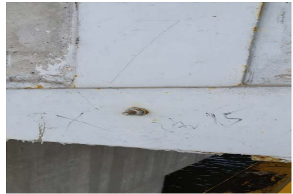
图 1-12 7#钢板下压条脱空 15cm
