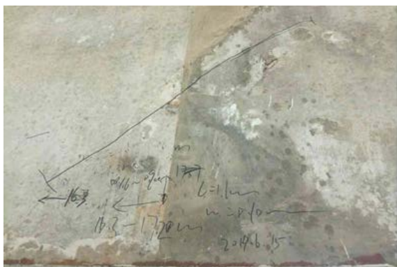
图 1-17 内侧腹板箱外面斜向裂缝
