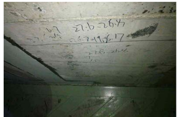
图 1-16 顶板箱内面纵向裂缝
