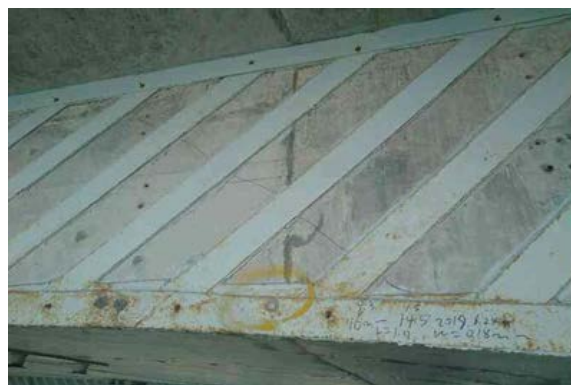
图 1-2 外侧腹板箱外面斜向裂缝
