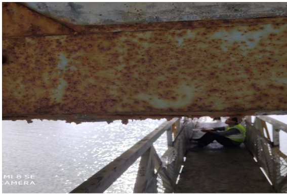
图 1-11 72#~84#钢板锈蚀、涂层剥落
