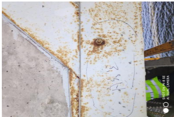
图 1-5 76#钢板锈蚀、脱空 21cm
