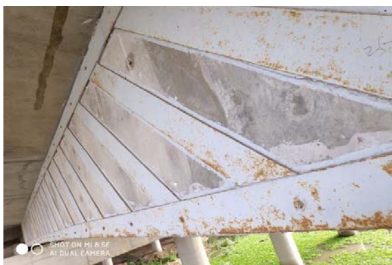
图 1-23 钢板下压条锈蚀、涂层剥落
