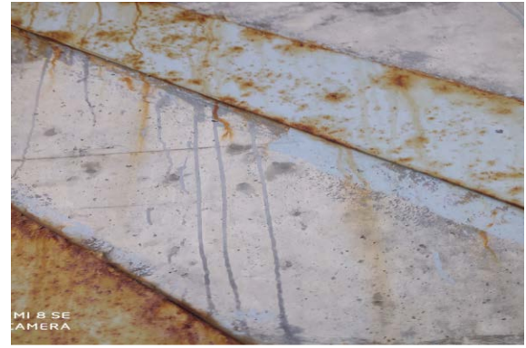
图 1-10 71#~73#钢板锈蚀、涂层剥落
