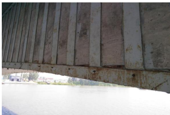
图 1-7 加固下压条整体锈蚀
